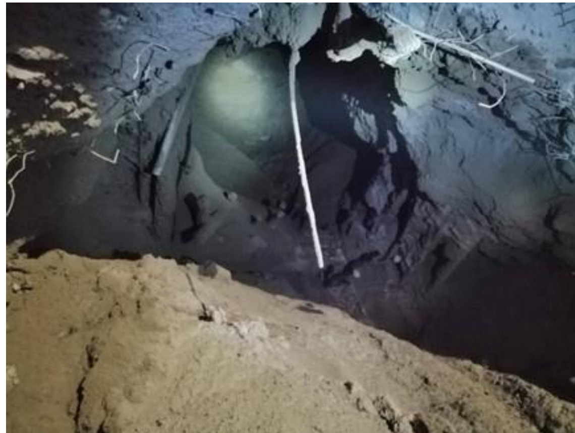
Gubitak stabilnosti i pojava kaverne u stropu desne cijevi tunela Ivan (pogled prema gore).
